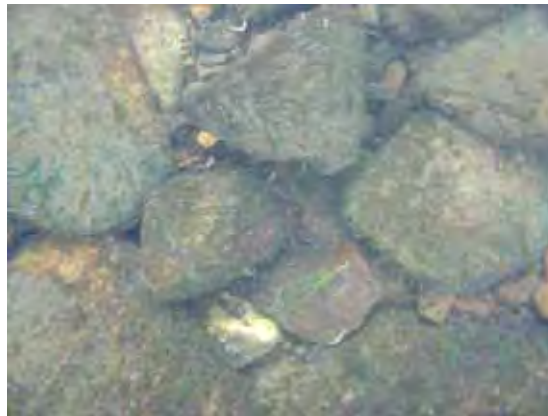
Bild 8.3.2-2: „Sohlpflasterung“ im Bereich T 08 oberhalb des Bahnhofes Wuppertal-Oberbarmen
