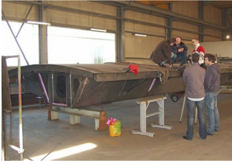
Neue Fischbauchklappe bei Werksabnahme vor Oberflächenbeschichtung
