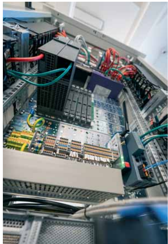
Neue Server in der Kläranlage Odenthal
