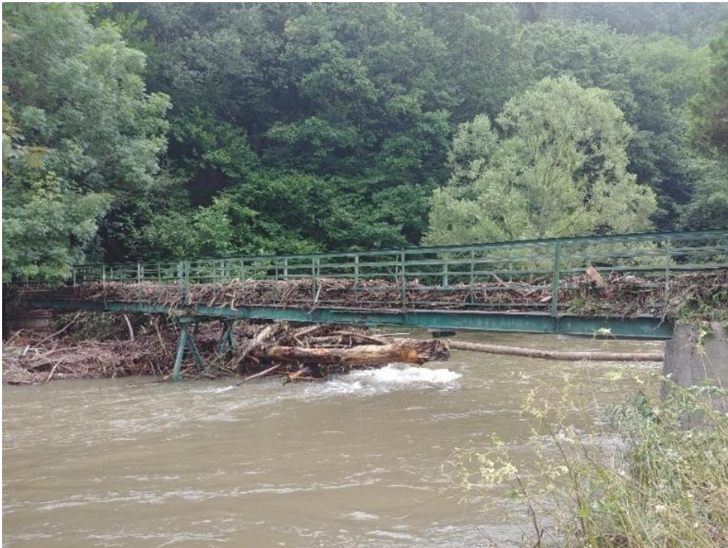
Verklauserung an Brücke Bilstein
